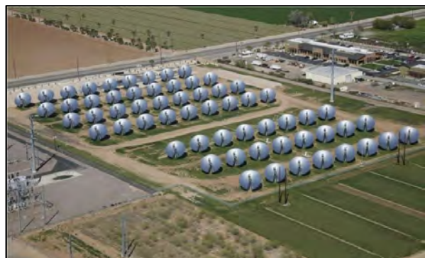
شکل 37: نیروگاه بشقاب خورشیدی ماریکوپا به ظرفیت 1/5 مگاوات در ایالت آریزونا آمریکا که ناتمام رها شد [51]
