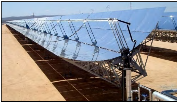
شکل 12: یک نیروگاه سهموی خطی
